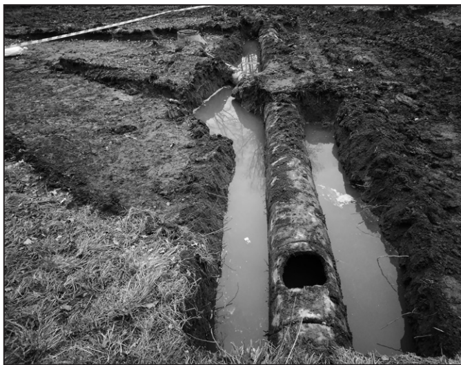
V parku Mezivodí je nutné vyřešit nefunkční kanalizaci. 2x foto: L. Holubníček
