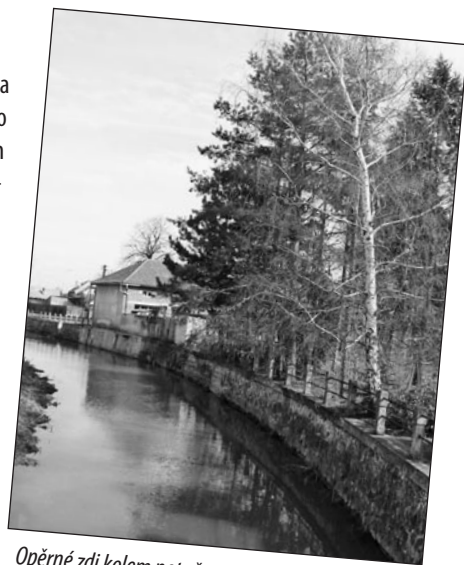
Opěrné zdi kolem notně zanesené Rusavy dostaly o povodňových opravách zabrat.
